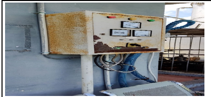
Pict 7. Electrical Source yang terdekat dengan Pipe Yard, namun belum dilengkapi dengan panel
