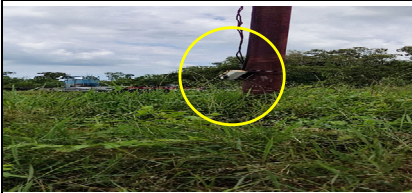
Pict 7. Electrical Source yang terdekat dengan Pipe Yard, namun belum dilengkapi dengan panel
